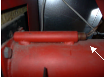
Rør til montering af føler fra termiskventil
